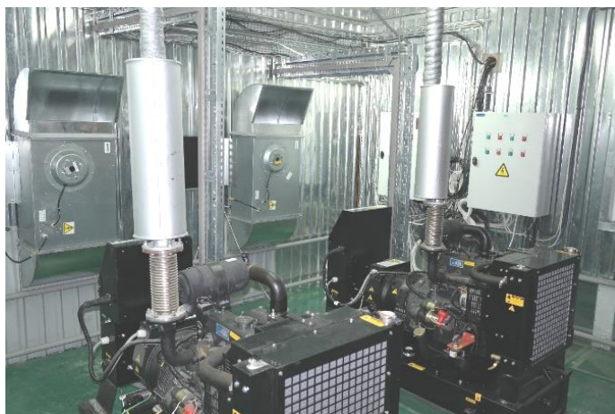
Рис. 6.12. Дизель-генератори ФМ САЕЕС: розташування у вентильованому морському контейнері
