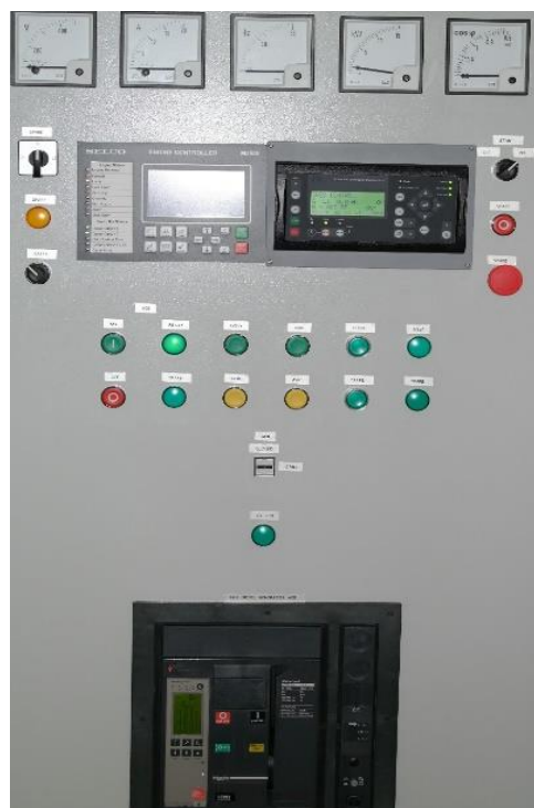
Рис. 6.13. Станція управління дизель-генераторами ФМ САЕЕС
